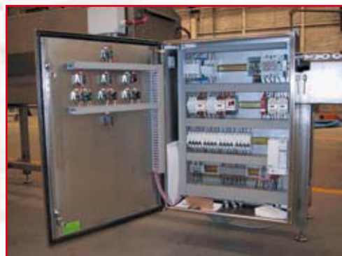
Coffret de commande électrique. Asservissement du tapis avec les infrarouges. Commande séparée des infrarouges.
