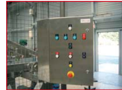
Armoire électrique de pilotage fixée sur l'enceinte grillagée répondant aux normes de sécurité en vigueur
