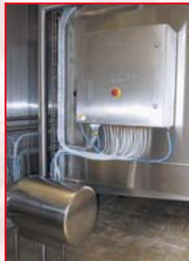
Débit pompe 70 m 3 /h sous 4 bars Triage Titration Contrôle de débit Contrôle de conductivité
