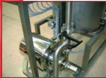
Pompe envoi lavage
