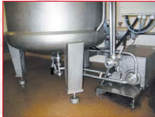
Ensemble de transfert produit par pompe. Pompe de mise en circulation du fluide caloporteur
