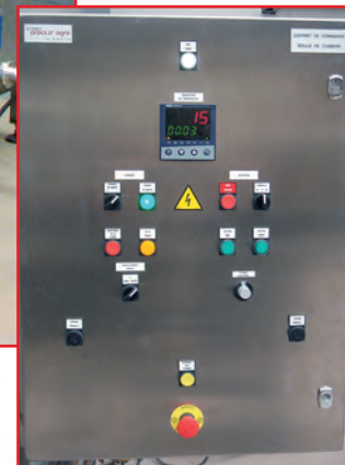
Armoire de commande Régulateur de chauffe Programmateur
