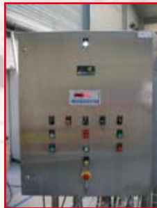
Armoire de contrôle commande avec afficheur de température et de poids
