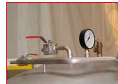
Rampe d'aspersion d'eau pour refroidissement
