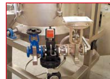
Panoplie vapeur Régulation de chauffe
